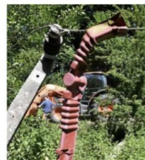
Der zweite Mast hatte bedrohlich Schräglage.
